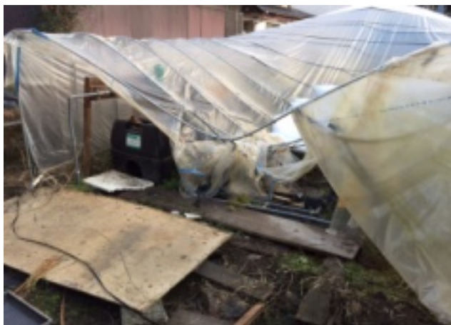
倒壊したビニールハウス (大島町)
